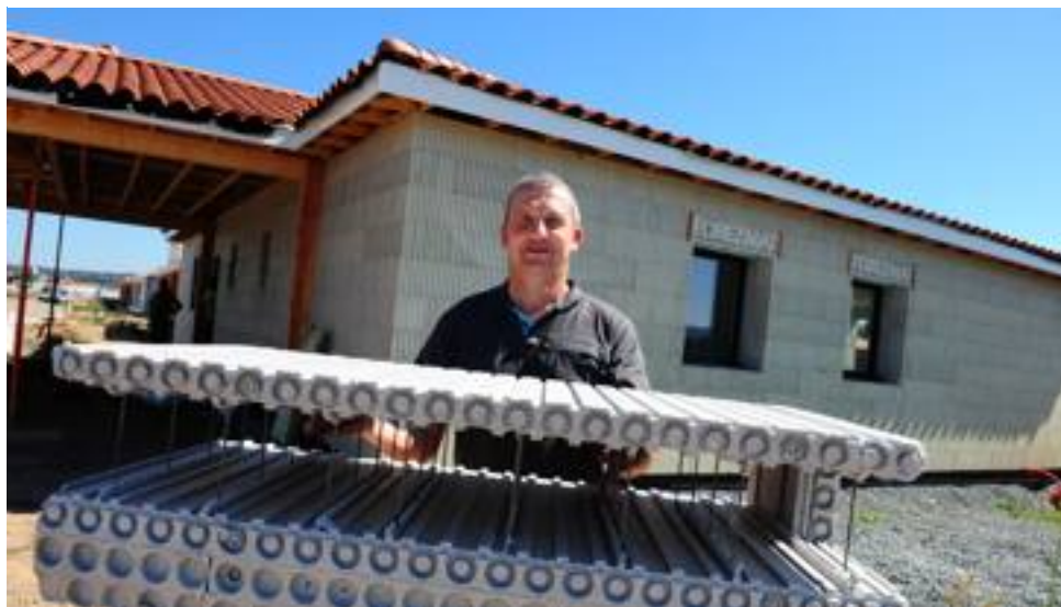
■ Les blocs de coffrage isolants s'empilent comme des lego® et que l'on remplit ensuite de béton. Photo Claude Essertel
