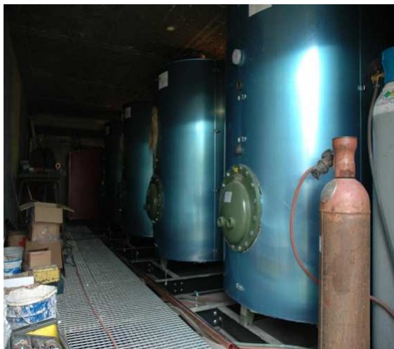
Local technique solaire au rdc – 4 ballons de 2 000 litres et compteurs énergétiques
