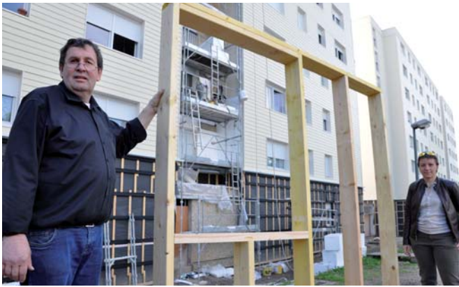
Bruno Segond présente les cadres qui ont servi à l'assemblage de l'ossature bois. En arrière plan, Christine Mouyon de l'Opac de Saône-et-Loire.
