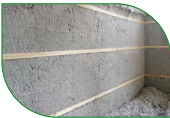
Utilisation d'isolants à forte capacité thermique (ouate de cellulose, fibre de bois dense) sur les parois les plus ensoleillées.
